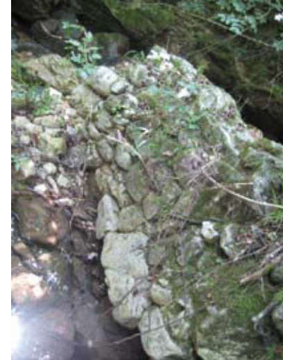
Strutture in muratura al centro del letto del Rujo dopo il ponte canale.
