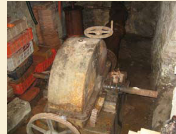
Turbina di alimentazione della macchina refrigeratrice.
